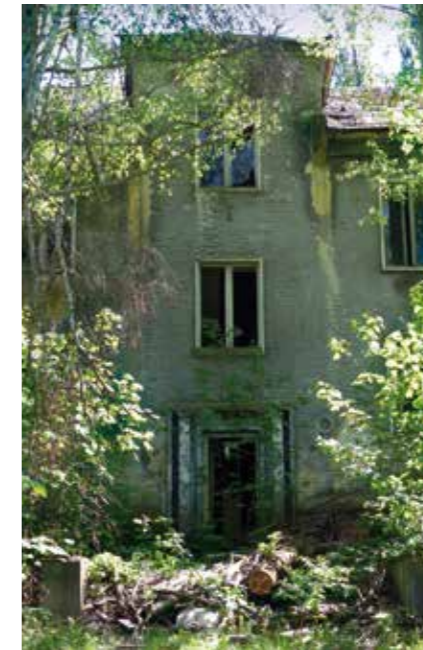
Im Keller der baufälligen Häuser finden Fledermäuse ihr Quartier. Foto: LHP/Vivien Taschner
