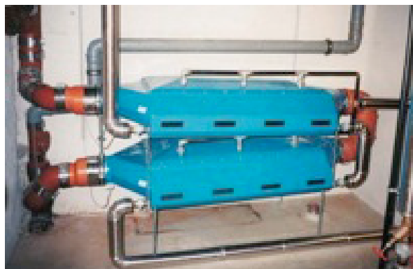
Abbildung 65: Wärmetauscher für gebäudebezogenen Systeme
