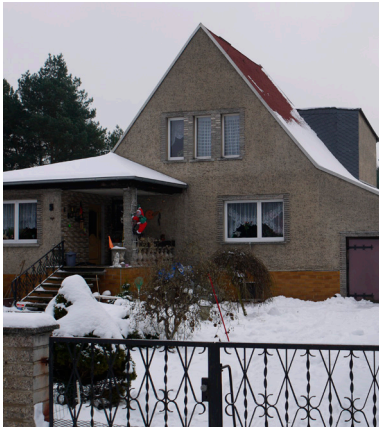
Abbildung 21: Ungedämmtes Dach im Winter (Priesterweg)
