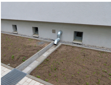
Abbildung 80: Das Niederschlagsfallrohr im Pilotblock ist in die Fassade integriert
