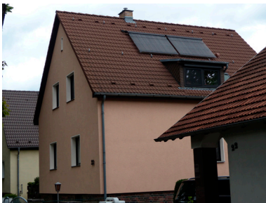
Abbildung 23: Solarthermieanlage in der Sternstraße
