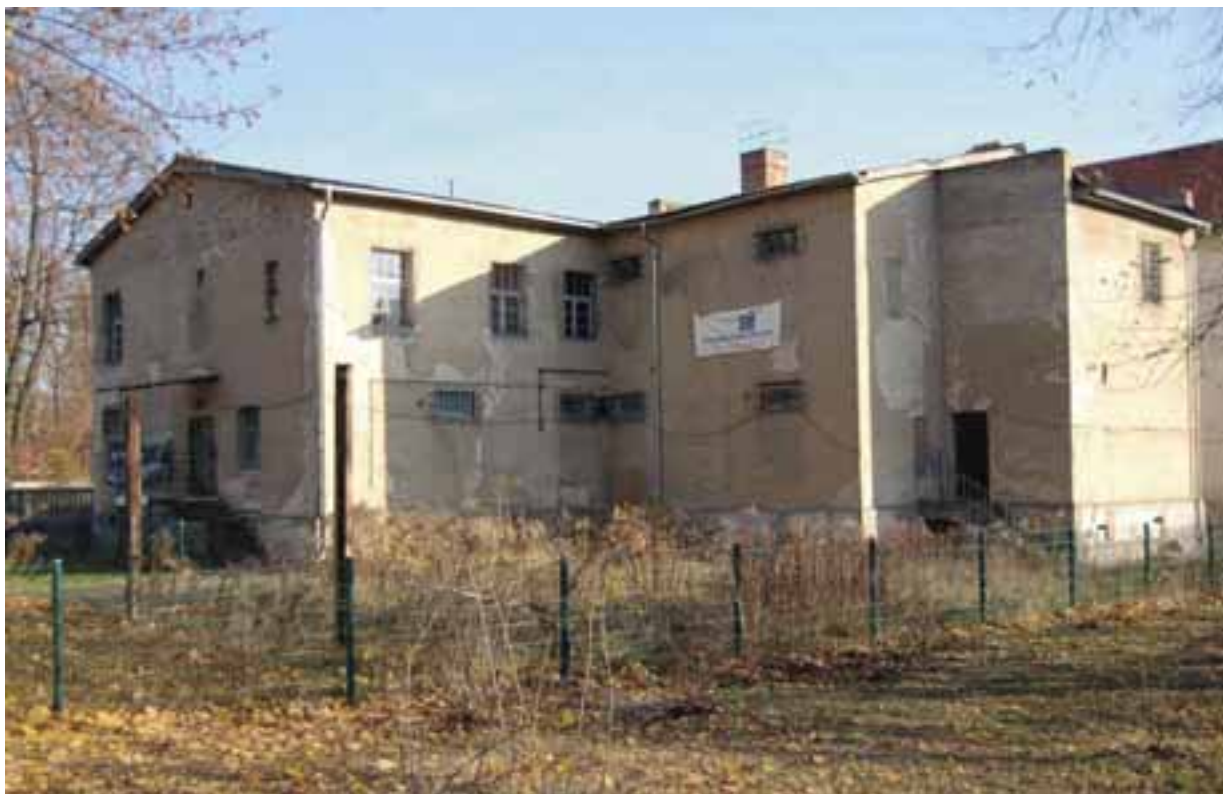
Abb. 2 –Gedenk- und Begegnungsstätte Leistikowstraße, Südwestansicht – Zustand vor der Sanierung, 2006
