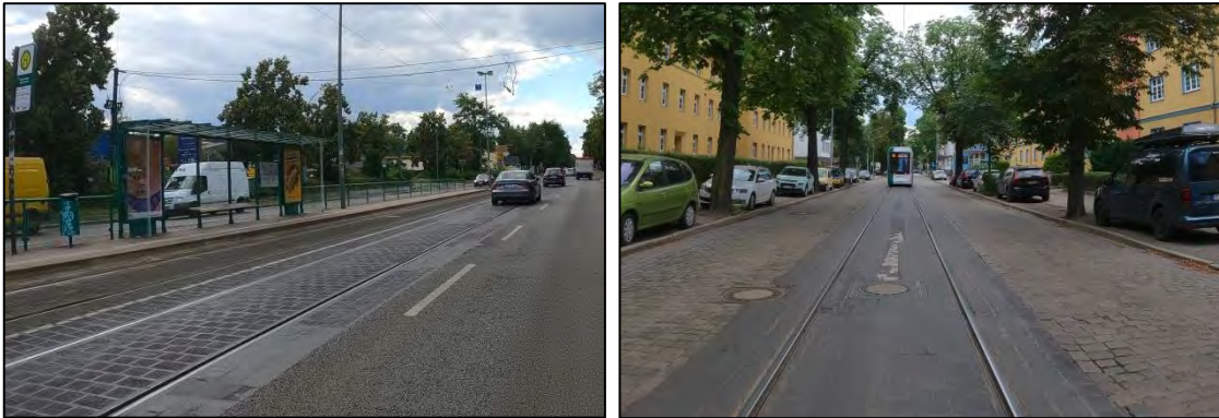
Abb. 3: Fahrbahnoberflächenanierungsbedarf Zeppelinstraße / Kastanienallee
