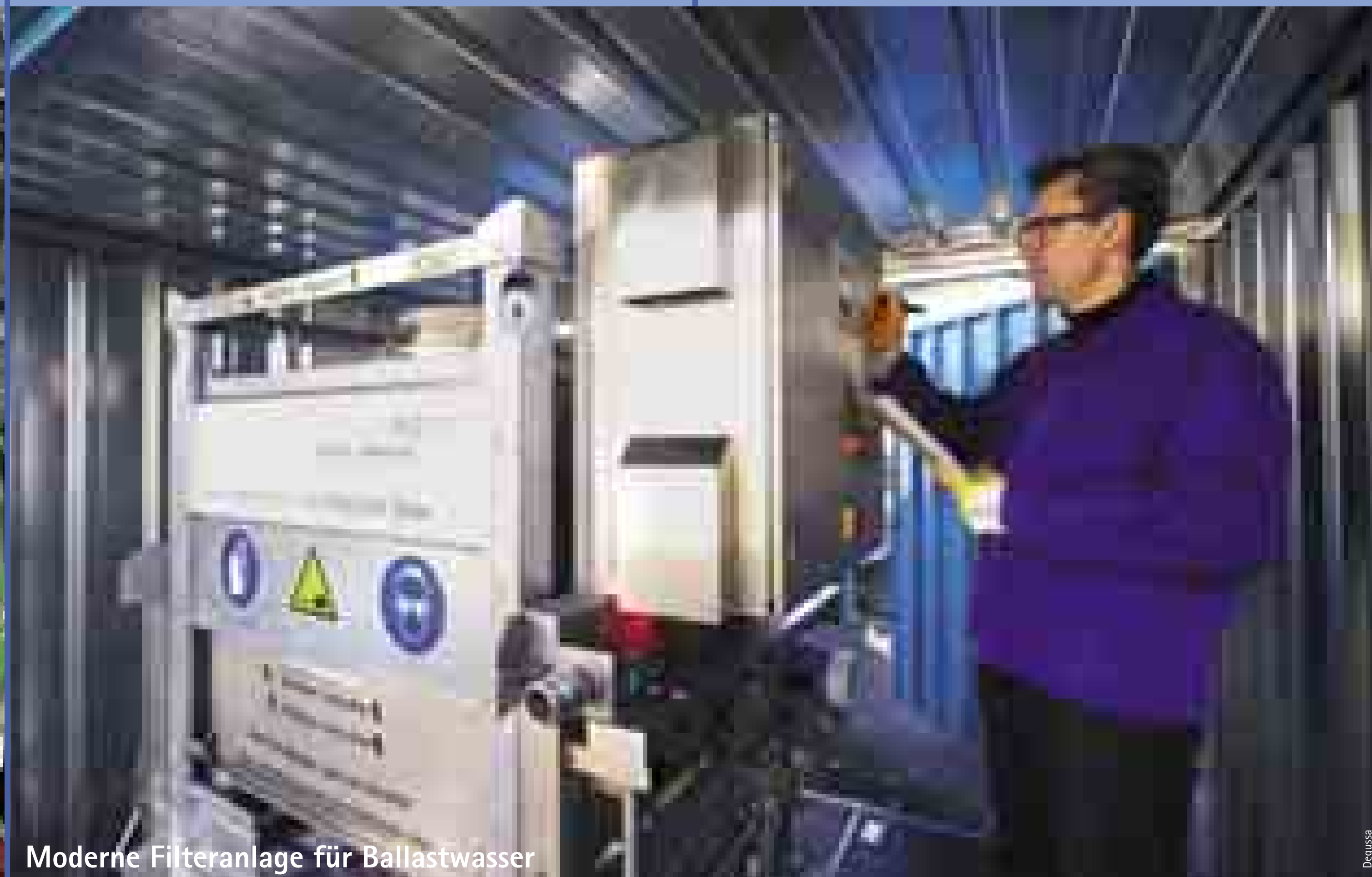
Moderne Filteranlage für Ballastwasser
